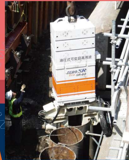
工事名: 横浜湘南道路引地川改良工事 (引抜き) 杭規格: 鋼矢板Ⅳ型(L=21.0m) 発注: 国土交通省
